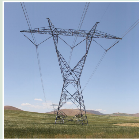
خط ۴۰۰ کیلوولت نیروگاه سهند بناب به نیروگاه ارومیه
