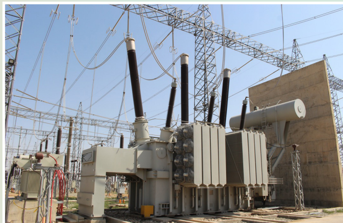
بی خط ۴۰۰ کیلوولت نیروگاه ارومیه
